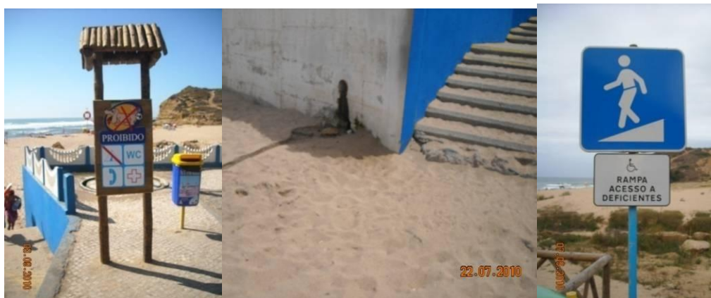
Legenda: Ribeira D' Ilhas – Rampa de acesso a deficientes / Escorrência para o areal e degrau danificado / Sinalética adequada (esquerda para direita)
